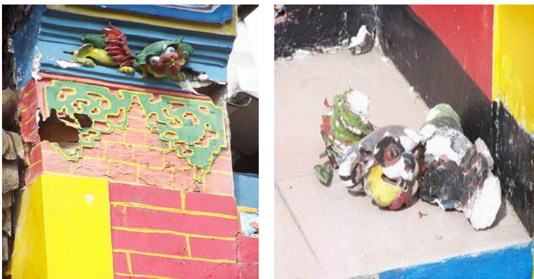
Foto 5. Tiang penyangga atap dan hiasan naga di Klenteng Gondomanan yang rusak akibat gempa
