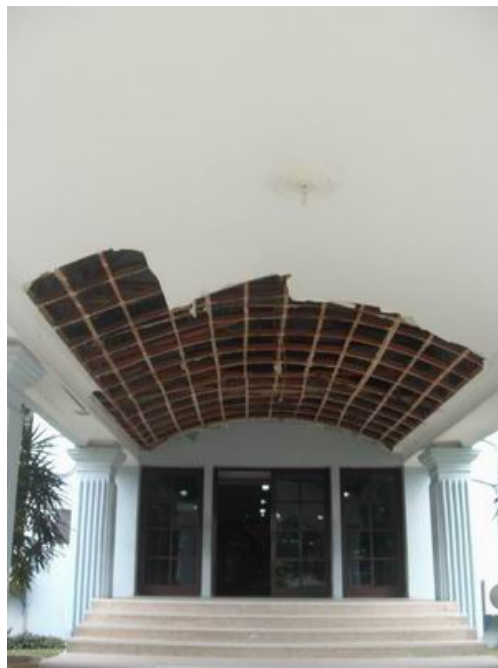
Foto 4. Atap Museum Dirgantara yang rusak akibat gempa
