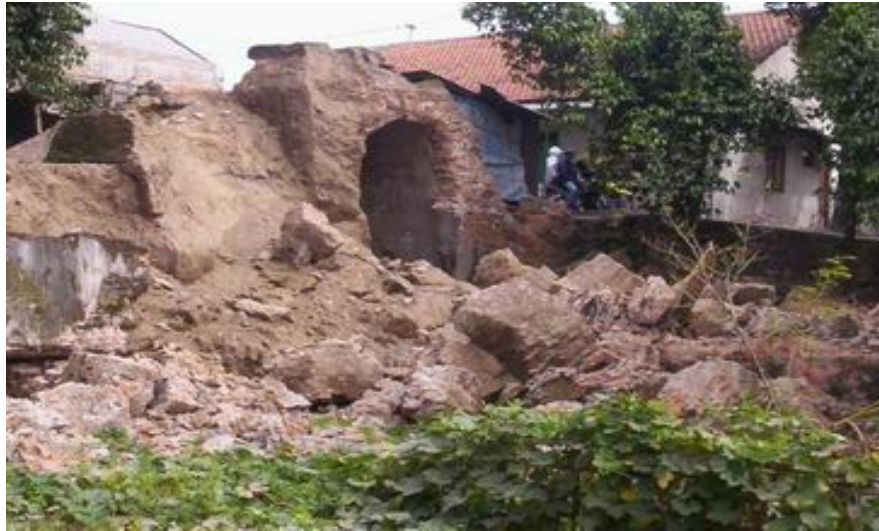
Foto 7. Bangunan bagian utara di Situs Warung Boto yang roboh
