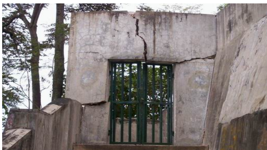
Foto 6. Situs Cendana Sari mengalami kerusakan struktural pada pintu masuk makam
